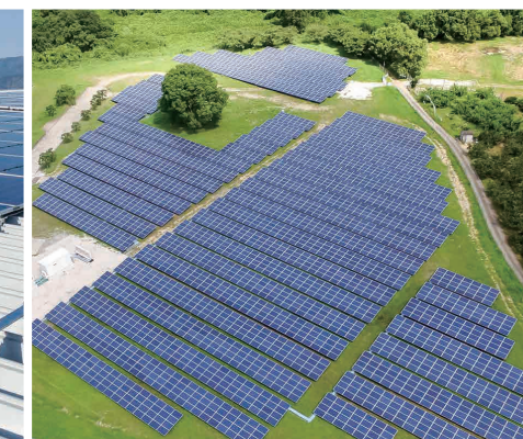
メガソーラー 和歌山県伊都郡 / 1.25MW
