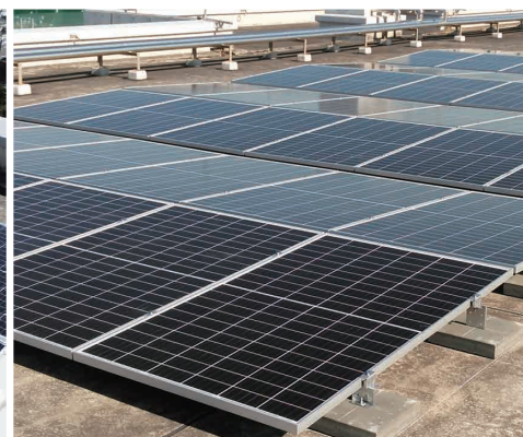
学校陸屋根 千葉県千葉市 / 80.5kW
