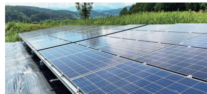
奈良県吉野郡大淀町 設置容量：99.38kW
