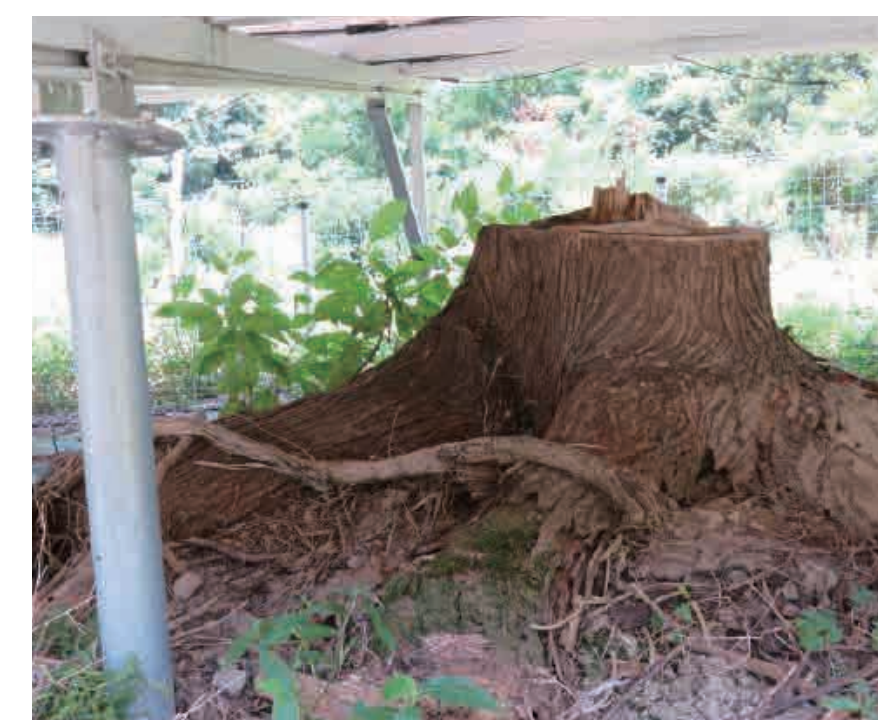
徳島県 | DC 35.6kW / AC 29.7kW
