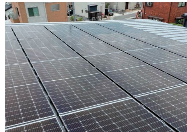
発電容量：5.7kW | 戸建て住宅 O様邸 所在地：和歌山県
