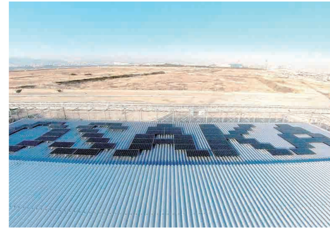
発電容量：16.4kW | 大阪・関西万博 大阪ヘルスケアパビリオンバックヤード棟 所在地：大阪府大阪市
