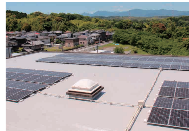
発電容量：72.96kW | 桑名市 多度まちづくり拠点施設 所在地：三重県桑名市
