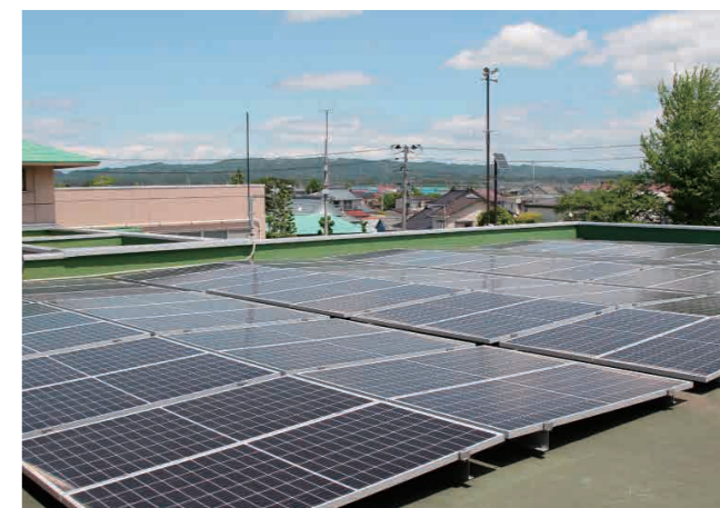
発電容量：38.4kW | 美里町健康福祉センター 所在地：宮城県美里町
