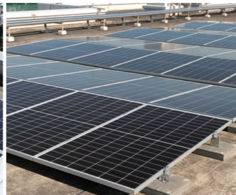
学校陸屋根 千葉県千葉市 / 80.5kW
