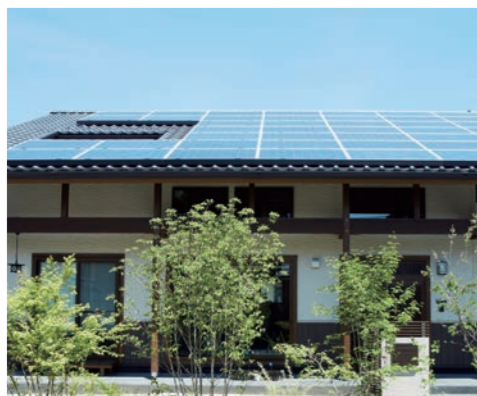
住宅屋根 栃木県宇都宮市 / 10.32kW
