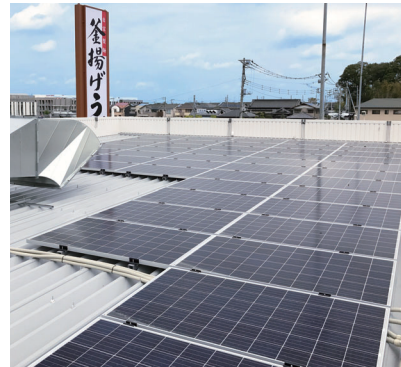
株式会社丸亀製麺 様 (丸亀製麺 大宮西店) 設置容量：12.96kW
