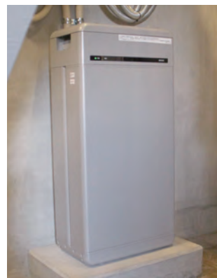
屋内に設置された蓄電池。停電時など非常時の防災用電源として活用できるだけでなく、日常的な電気購入量の削減にも貢献する。
