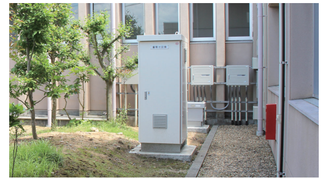
屋外に設置された蓄電池。万が一の停電時に電気を使えるようにするだけでなく、日常的な電気購入量の削減にも貢献している。
