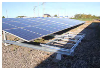
手順② 横レールとモジュール設置用縦レールを取り付け
