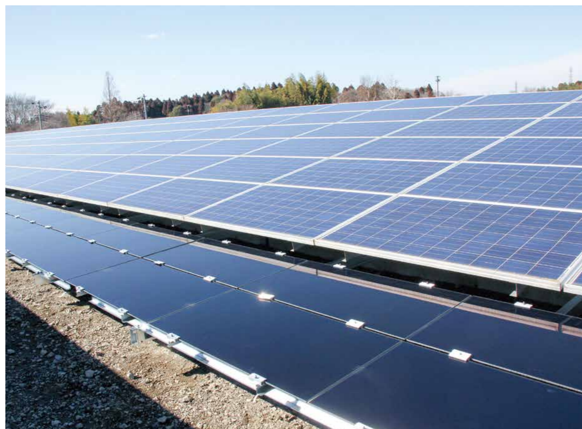
X-large Fastで増設したエクソル八街発電所
